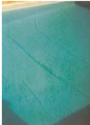
13. Arrugas debidas a la presencia de agua detrás de la membrana.
