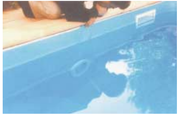
10. Alteración de la membrana de estanqueidad por productos químicos demasiado agresivos.
