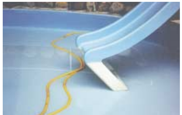
11. Alteración por productos químicos demasiado agresivos.
