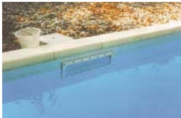
2. Depósito de grasa en la línea del agua, debido a una mala aspiración por los skimmers.
