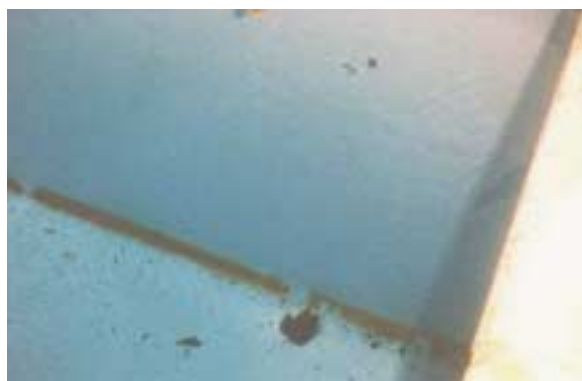
3. Depósito de óxido.
