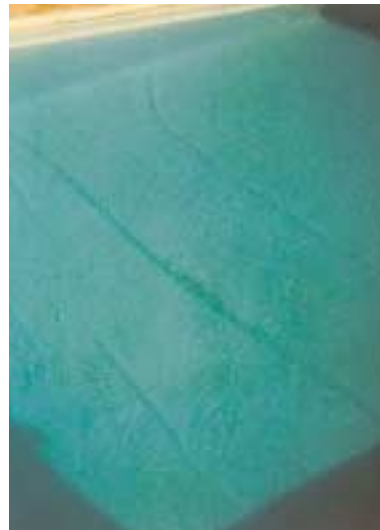
13. Falten infolge von Wasser hinter der Schwimmbeckenauskleidung.
