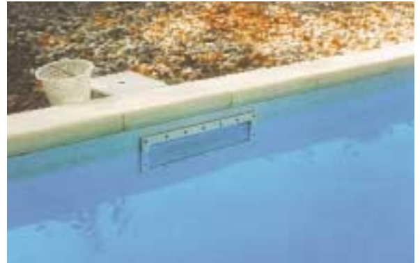
2. Ablagerung von Fetten an der Wasserlinie wegen schlechter Absaugung.
