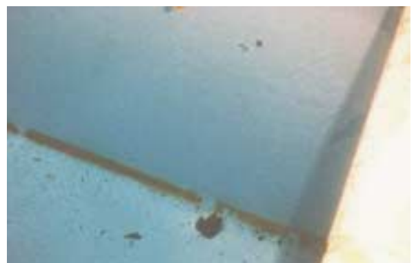
3. Ablagerung von Rost.
