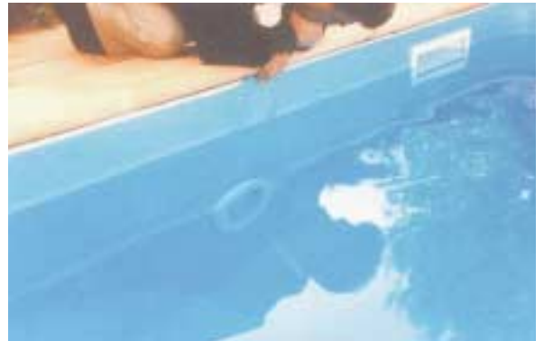
10. Ausbleichen der Abdichtungsmembran durch aggressive Chemikalien.
