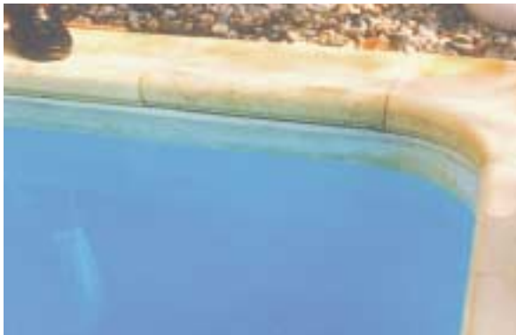
1. Kalkablagerung über der Wasserlinie.
