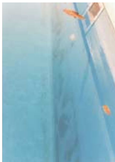
9. Die Wandelemente enthalten Farbstoffe, die durch die Abdichtungsmembranen migrieren.
